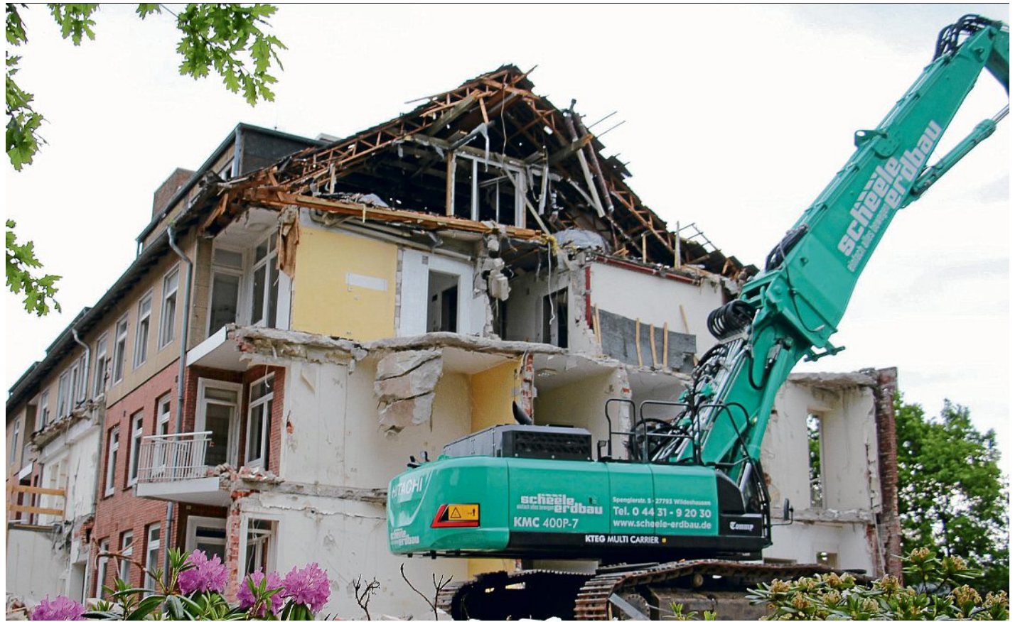
An der Landwehrstraße ist der Bagger angerückt: Ein alter Bestandteil des Hauses St. Hedwig verschwindet von der Bildfläche. Im Neubau sollen eine Zentralverwaltung angesiedelt sowie zusätzliche Kapazitäten für die Küche und Pflege geschaffen werden. Foto: Speckmann
